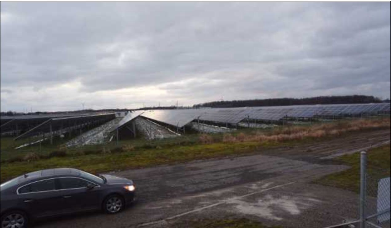
▶ 할디만디 태양광 발전소 현장사진 1
